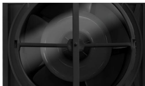
Ventilátor je vybaven zpětnou klapkou.
